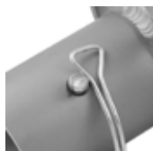
Figura 3 Pasador de acoplamiento de pata indebidamente asegurado
